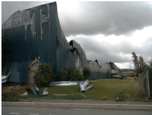
Vue de l'extérieur d'un entrepôt de lait en poudre. (Structure métallique) L'effondrement des bardages n'est pas total.
